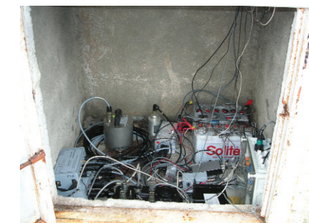
Instrumentos geofísicos instalados en enero y febrero de 2004 (sismómetros, sensor de presión y sensor acústico).
